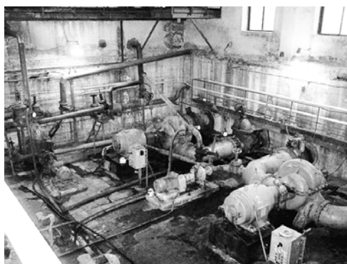
Рис. 43 – Общий вид помещения насосной станции
