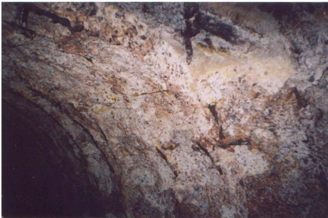
Рис. 2.1 — Разрушенный свод бетонного коллектора
