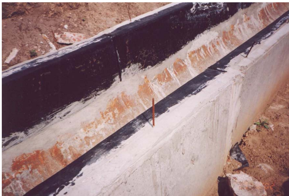
Рис. 2.10 — Лотковая часть канализационных трубопроводов, защищенная полиэтиленовым листом
