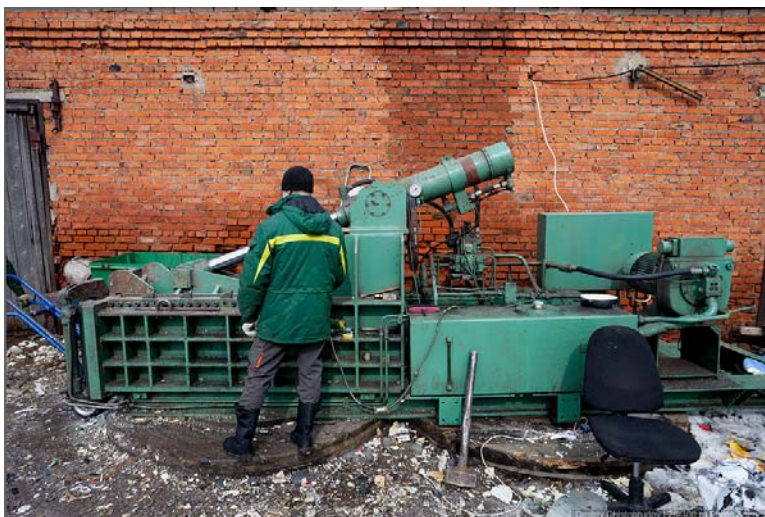
Рис. 3.5. Фото пресса со стороны зоны обслуживания (600-тонный пресс)
