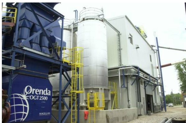
Рис. 6.4. Пиролитическое оборудование переработки биоотходов
